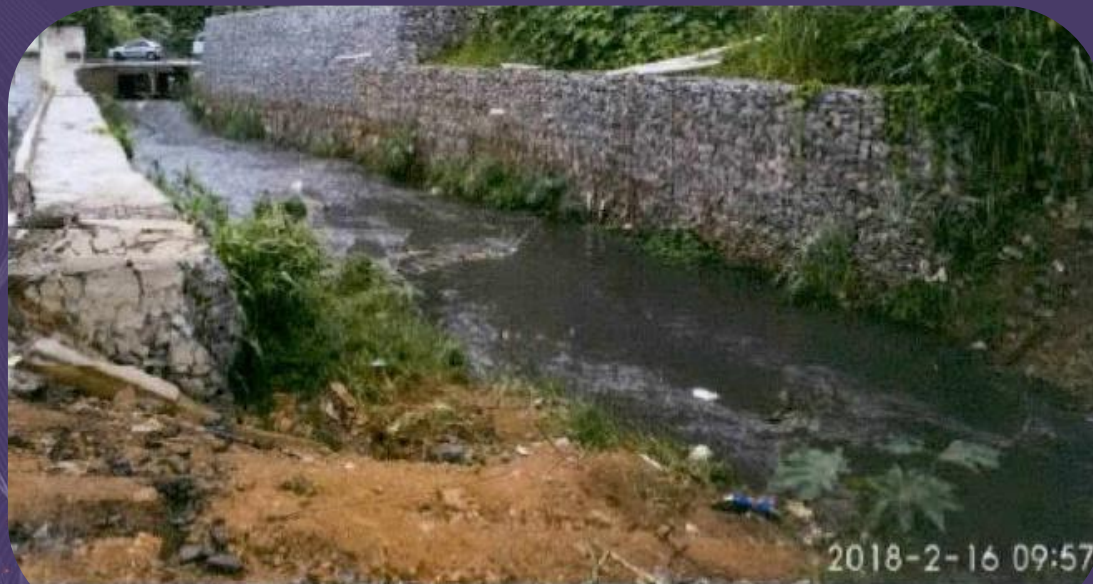
Talude da margem do Córrego rompido
